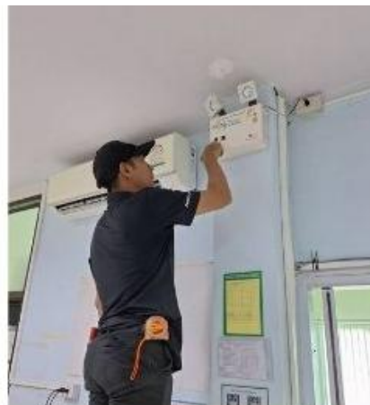
ภาพแสดง ตรวจสอบคอมไฟฉุกเฉินประจำเดือน
